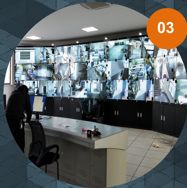
某小区监控中心
